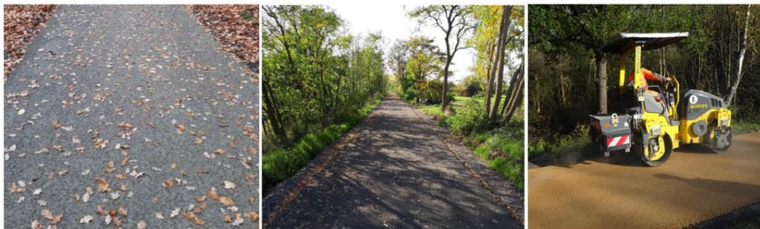
Abbildung 4: Asphaltähnliche Deckschichten aus Gemisch von Basaltstein und Spezialsanden / heller Split-Mastix-Asphalt
